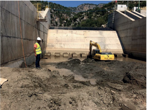
► HES Enerji Kırıcı Havuzu Silt Temizliği
